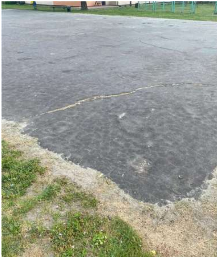
Fot.2 Liczne spękania i wgniecenia.
